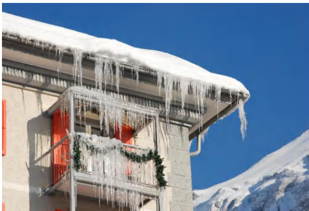
Zu viele Eiszapfen für dieses Dach
